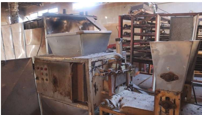
Zerstörte Fabrik in Rojava. FOTO: ANF
